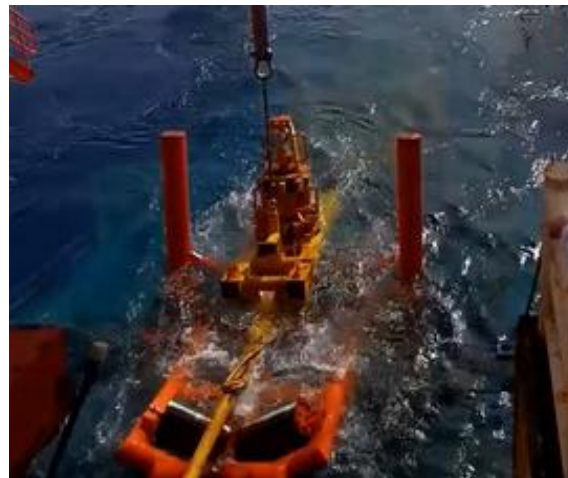
分体式管道终端/三通结构物在线安装 PLET / ILTA S-lay Installation
